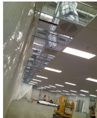
Plafon clean room en Foxconn
